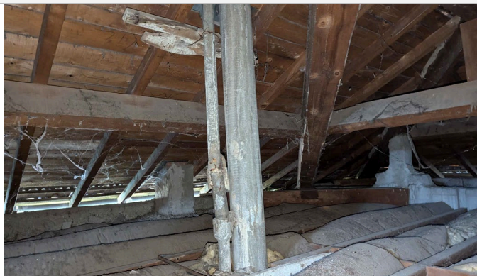
Grille d'évaluation n°1 et 2 : Conduits de fluides et fumées en amiante-ciment dans combles
